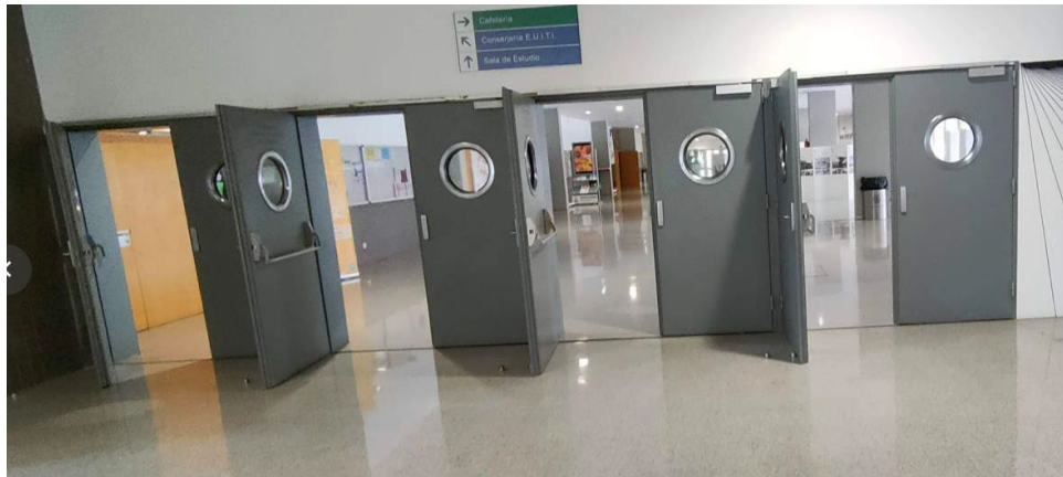
Sistema barra cierrapuertas acceso aulas PB (Betancourt).
