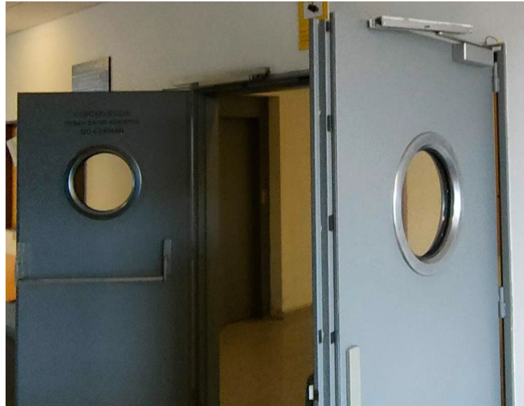
Ejemplo de barra cierrpuertas arrancada.
