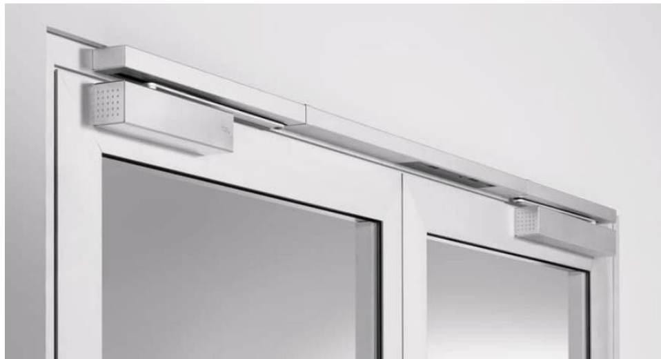
Sistema barra cierrapuertas instalado y conectado a la central de incendios.
